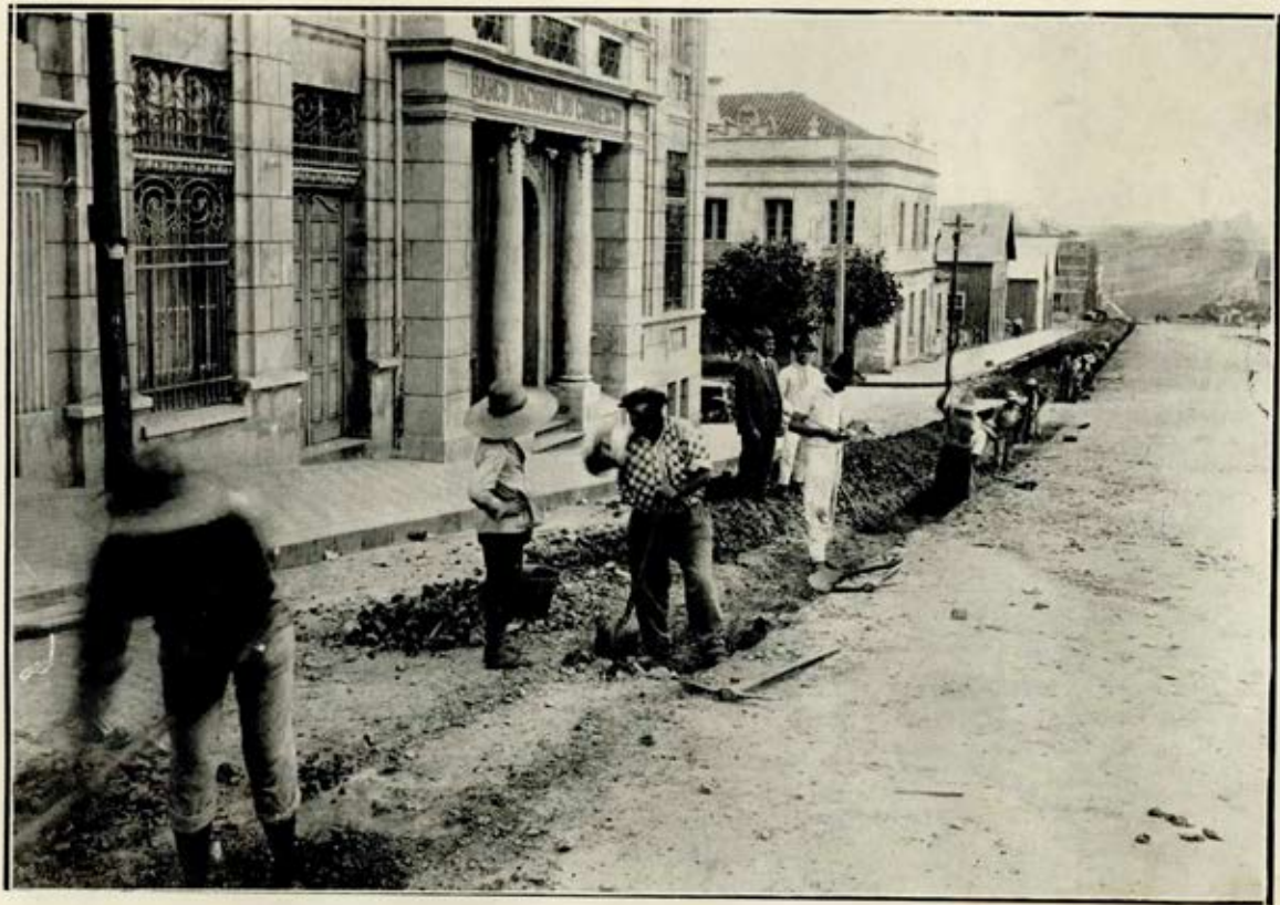
Linha de distribuição do Reservatório N.º 1, da cidade.
